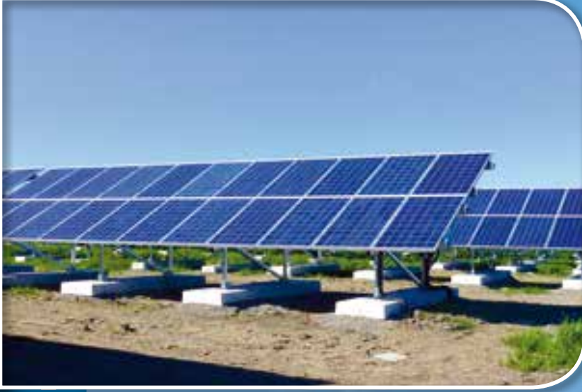
Solarpark auf dem ehemaligen Deponiegelände in Herzmanns. 2.700 Module liefern 611.000 kWh Strom pro Jahr.
