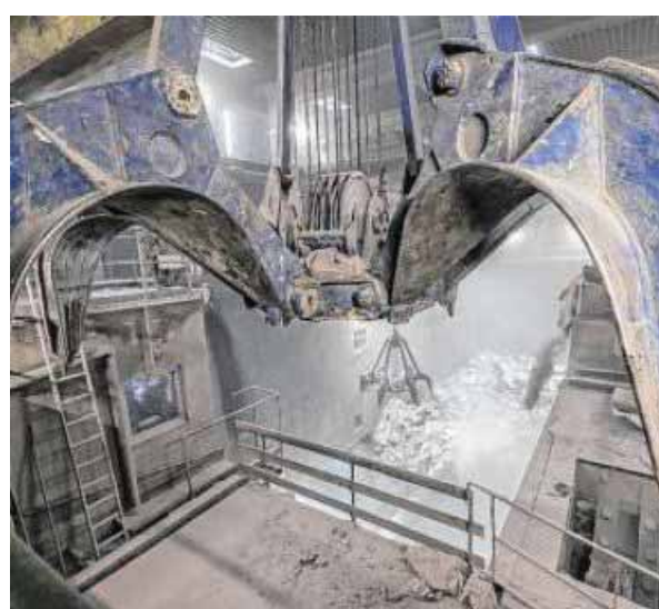
Im Müllheizkraftwerk fließt im kommenden Jahr Geld unter anderem in eine Vergärungsanlage für Biomüll. Foto: Ralf Lienert
