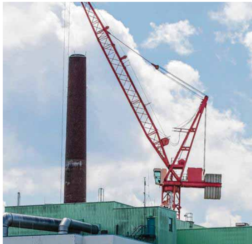
Nach 26 Jahren wurde die alte Rauchgasreinigung am Müllheizkraftwerk abgerissen. Die neue Anlage filtert effektiver und gewinnt mehr Energie zurück. Foto: Ralf Lienert
