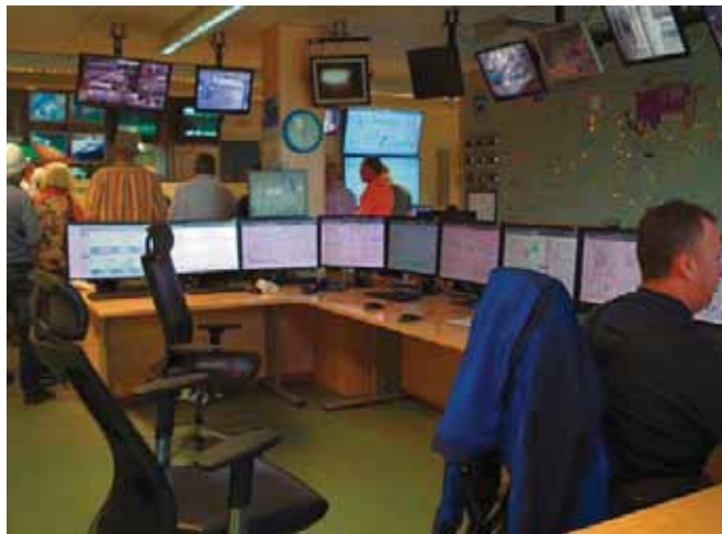
Hier laufen alle Fäden zusammen: die Steuerzentrale des Müllheizkraftwerks in Ursulasried. Foto: Tröger
